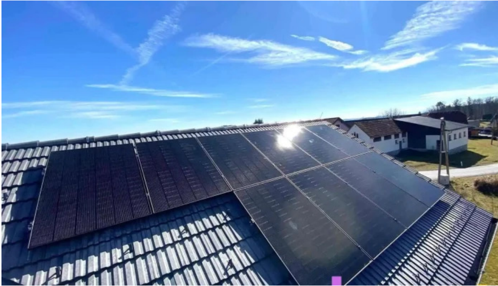
Enerix wolfsberg photovoltaik stromspeicher vom inhaber
