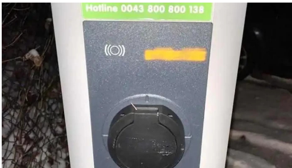
Energie steiermark ladestation irdning
