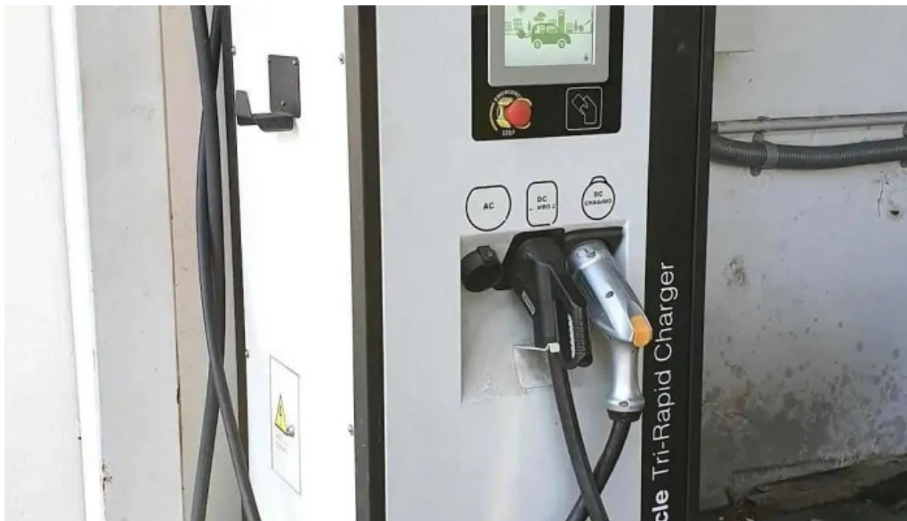
Da emobil ladestation alle
