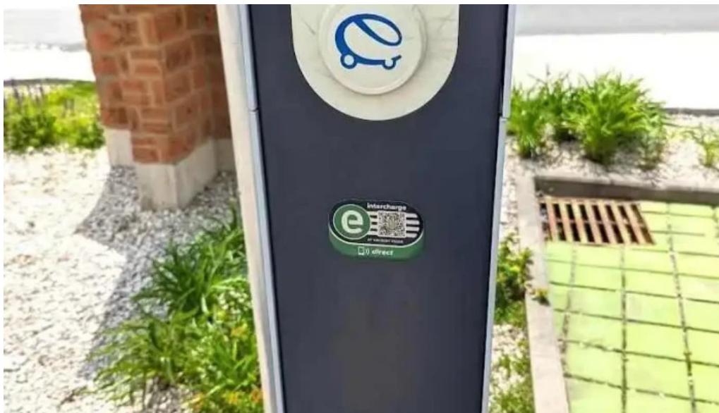
Stadtwerke klagenfurt ag ladestation grafenstein
