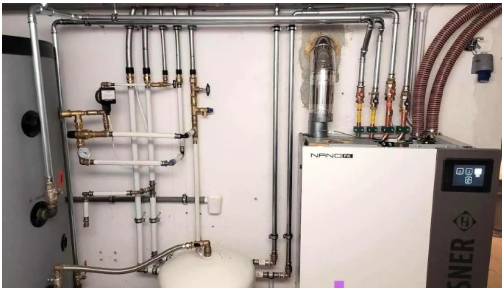
Energietechnik danhofer eferding
