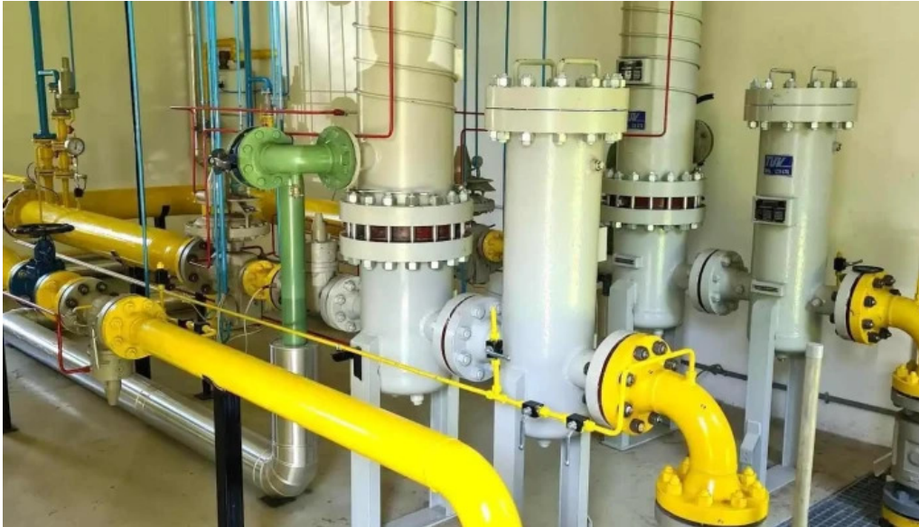
Gasnetz energie klagenfurt gmbh alle
