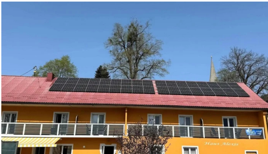
Ebz energie gmbh fotovoltaik solarstromanlage
