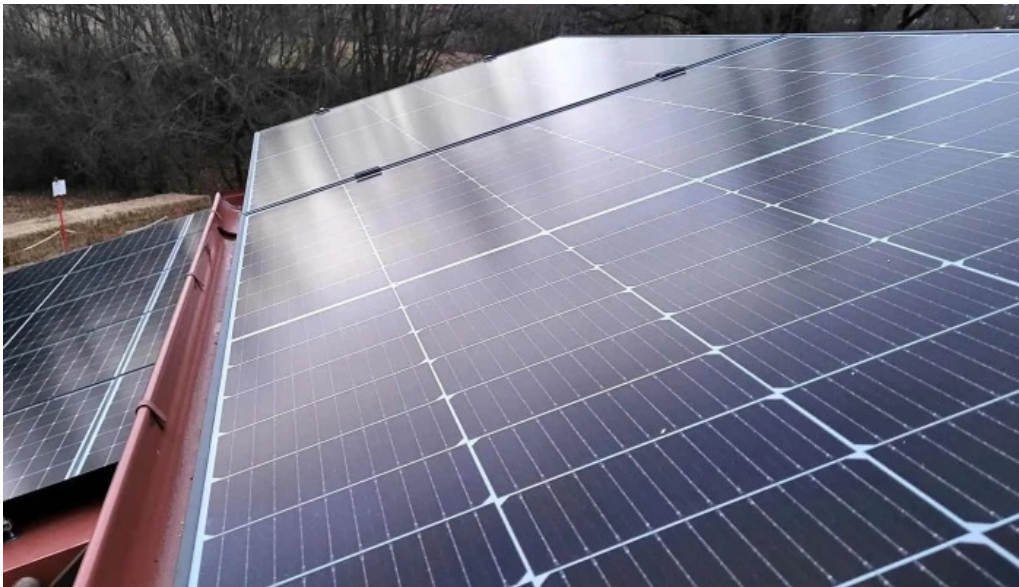
Etr energietechnik kirchbach zerlach kittenbach w 4a
